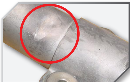
7. Deformované, ohnuté, preliačené hlavné potrubie
