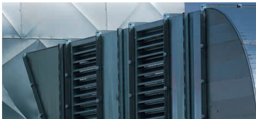
Impianto di ventilazione
