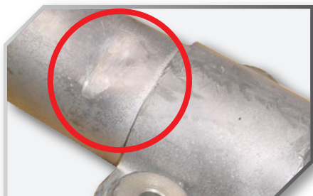
7. Conductă principală deformată, îndoită, turtită
