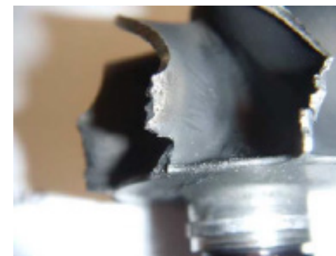
Turbina dello scarico danneggiata
