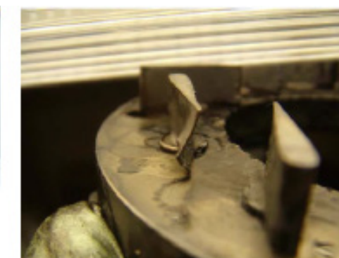
Alabes de tobera dañadas
