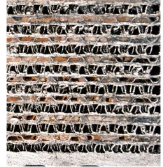
Загрязненные пластины охлаждения
