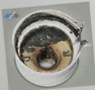
Рис. 18: Вид в разрезный корпус шестерёчатого насоса E37, забитого отложениями
