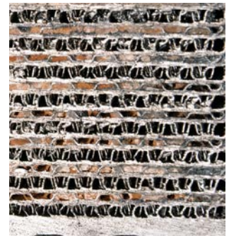
Láminas de refrigeración obstruidas
