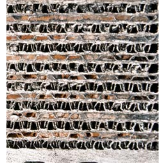
Tıkalı soğutma kanatçıkları
