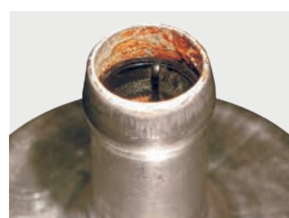
Zardzewiały wlot pompy (uszkodzenie przez wodę)
