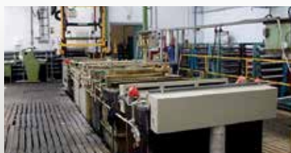
磷化处理设备
